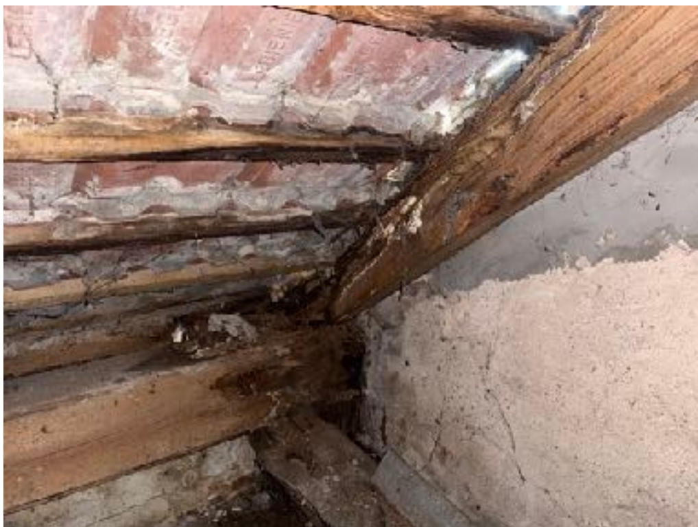
Fot. 27 Zbliżenie na starsze belki i korozję w ich obrębie.
