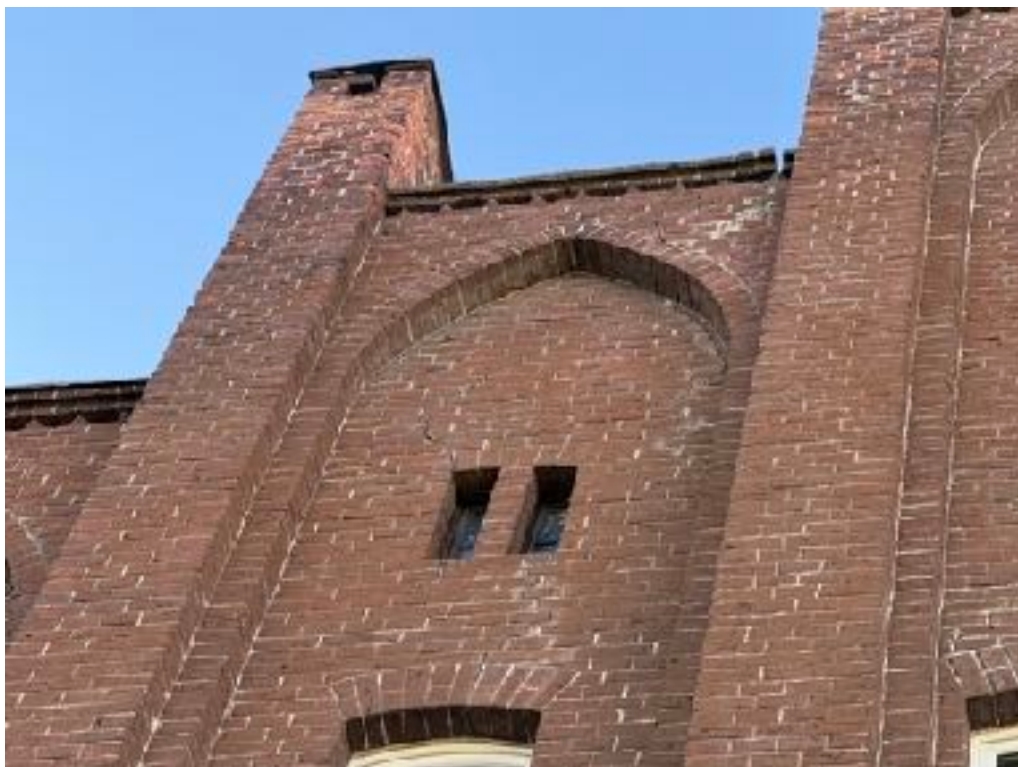
Fot. 14 Zbliżenie na szczyt z widocznymi spękaniem i obluzowanymi cegłami.
