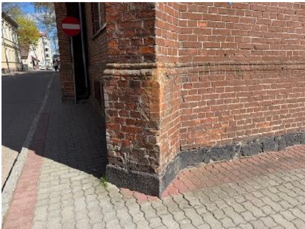
Fot. 10 Zbliżenie na zdegradowania i uszkodzenia cegieł w obrębie szkarpy.
