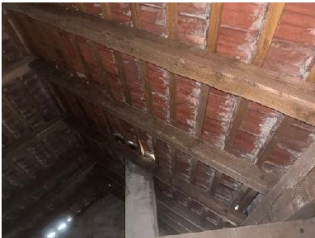
Fot. 26 Widok na więźbę dachową. Widoczne prześwity.
