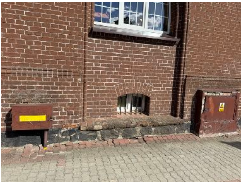
Fot. 9 Strefa cokołowa w elewacji zachodniej. Widoczne mało estetyczne skrzynki z przyłączami.
