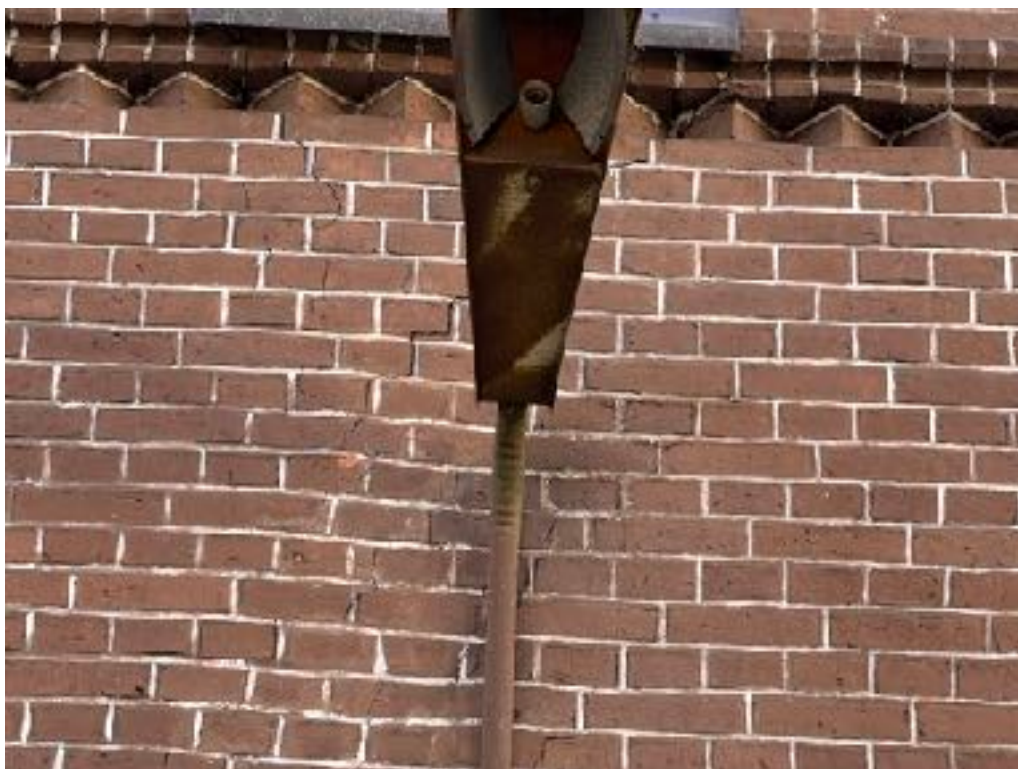
Fot. 13 Zbliżenie na widoczne spękania w obrębie wążku ceglanego. Widoczna mało estetyczna lampa.
