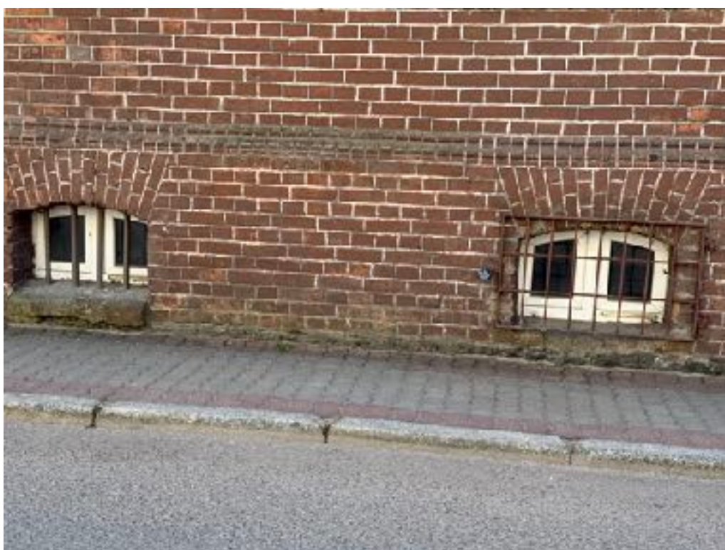
Fot. 3 Zbliżenie na cokół w elewacji północnej. Widoczne różne i wtórne kraty okienne.
