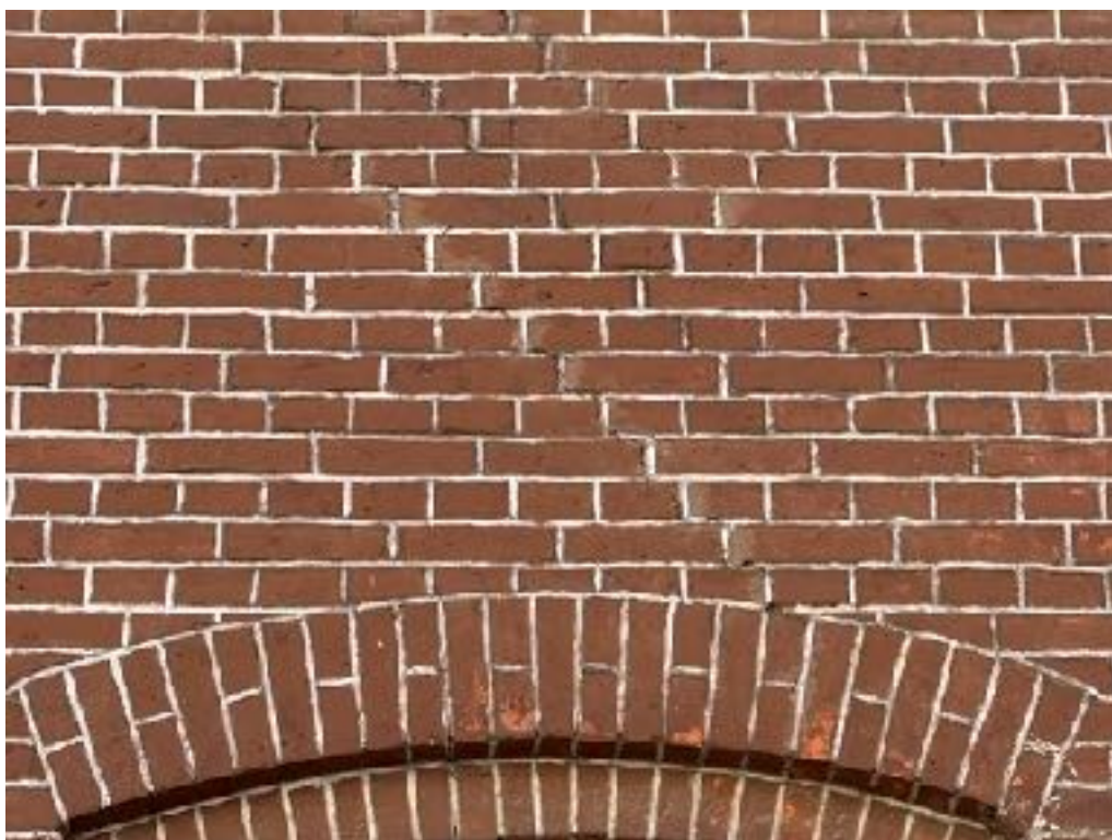
Fot. 4 Zbliżenie na pęknięcia, które należy spiąć. Widoczne przemalowania cegły i spoiny.
