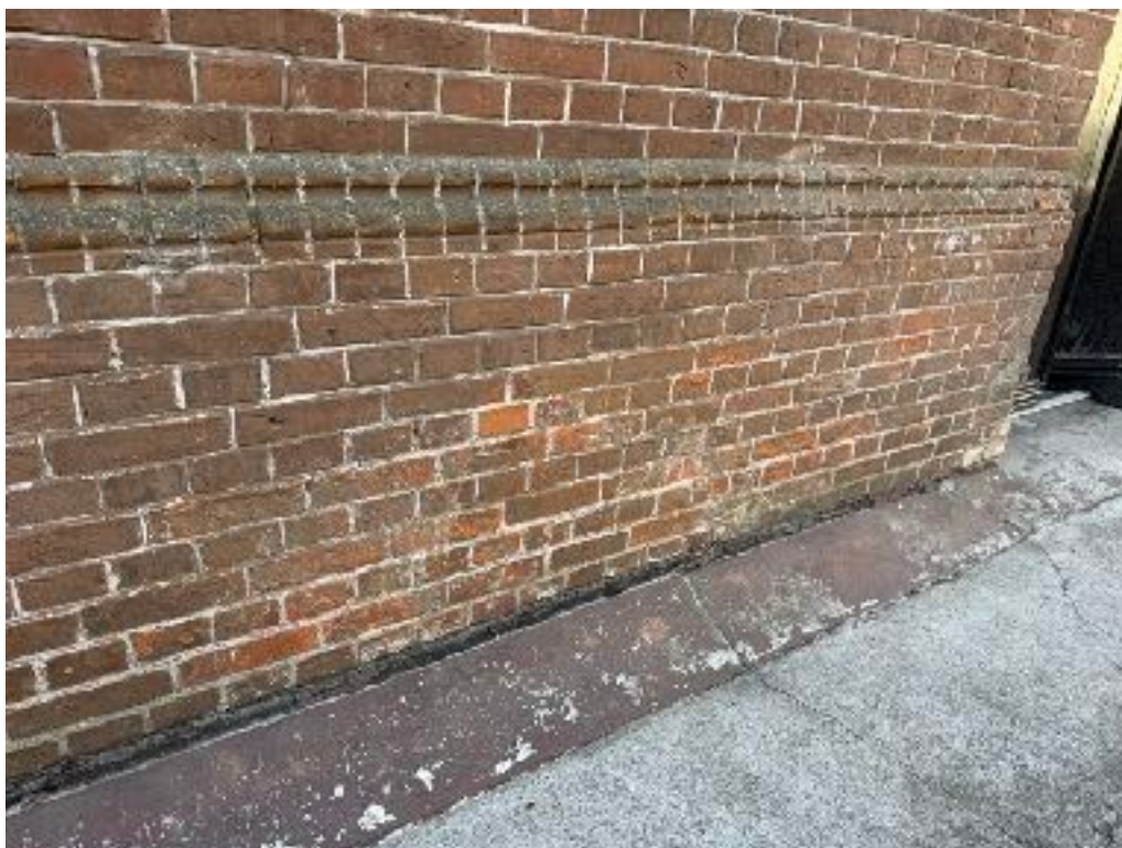
Fot. 16 Zbliżenie na partię cokołową z widocznymi wysoleniami oraz złuszczeniami wtórnych powłok malarskich.
