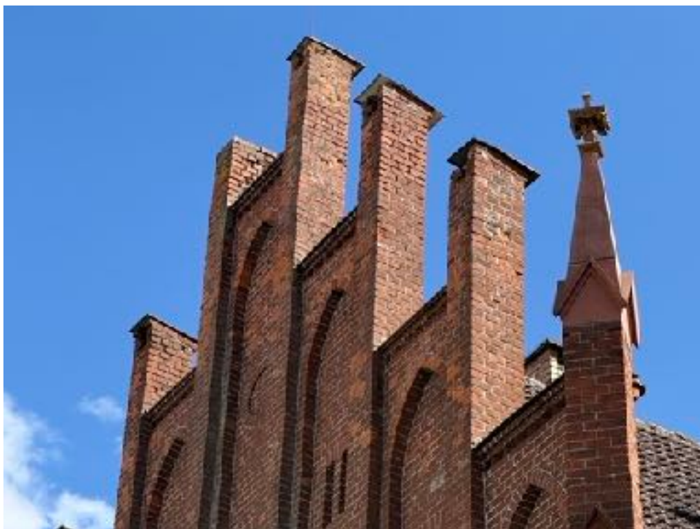
Fot. 2 Zbliżenie na szczyt w elewacji północnej. Widoczne ubytki w sterczynach oraz braki w opierzeniach.
