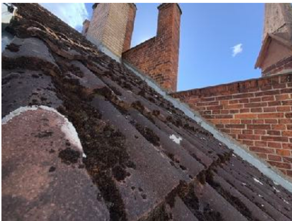
Fot. 24 Zbliżenie na betonową dachówkę ze zdegradowaną powierzchnią oraz atakiem biologicznym.
