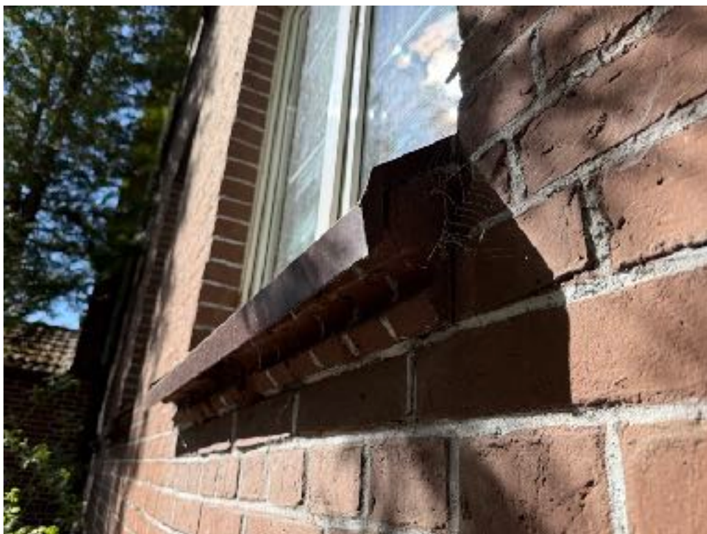
Fot. 20 Kształtki parapetowe przysłonięte przez opierzenia blacharskie.
